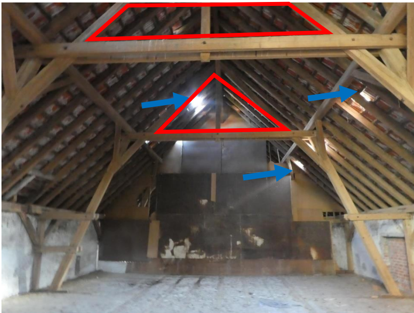
Abbildung 7: Fledermausquartier im Pfettendach (rote Umrandung), Ersetzen Glasziegel bzw. Ersetzen fehlende Ziegel (blauer Pfeil)
