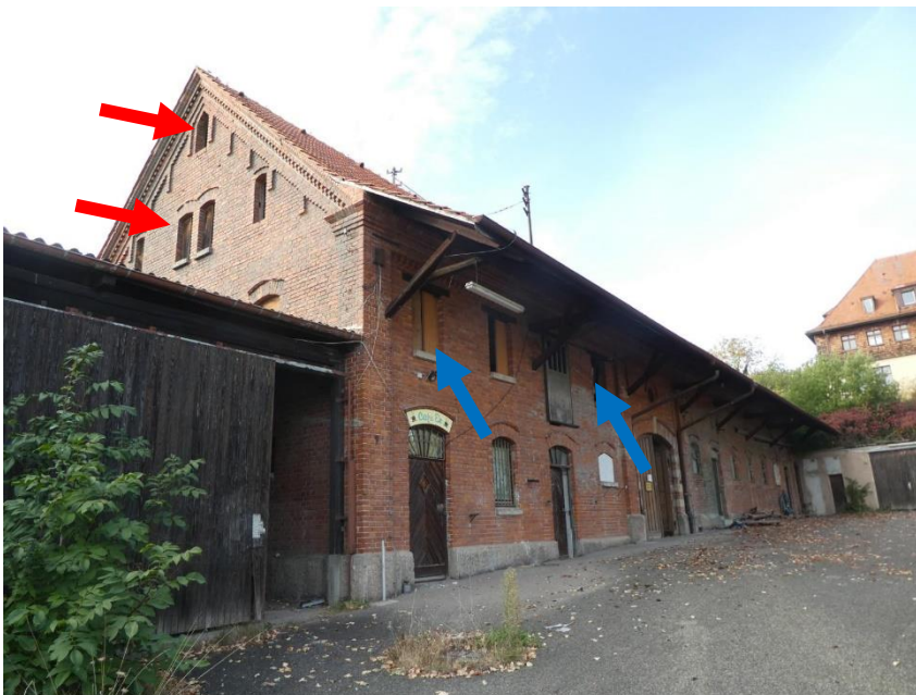
Abbildung 4: Giebelfenster mit Holzladen und Einflugspalte (roter Pfeil), Verschluss Fenster (blauer Pfeil) - Süd- und Ostseite
